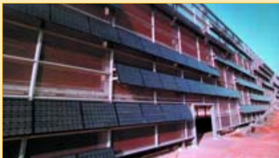
Figura 6: Captadores sobre estructura auxiliar en fachada
